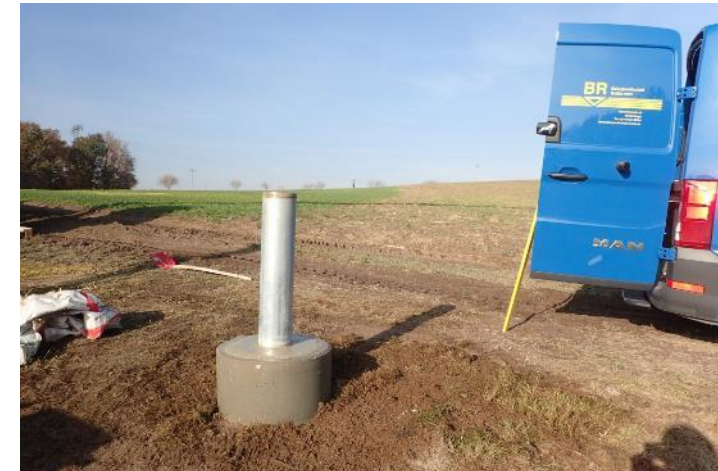
Abb.: fertig ausgebaute Grundwassermessstelle
